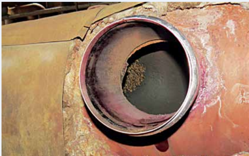
Рисунок 3 – Эрозия сборного коллектора DN 500 мм, расположенная с небольшим смещением по отношению к оси боковой врезки
