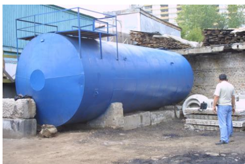
Фото 5. Резервуар объемом 70 м 3
