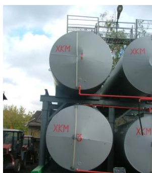
Фото 6. Резервуары объемом 50 м 3
