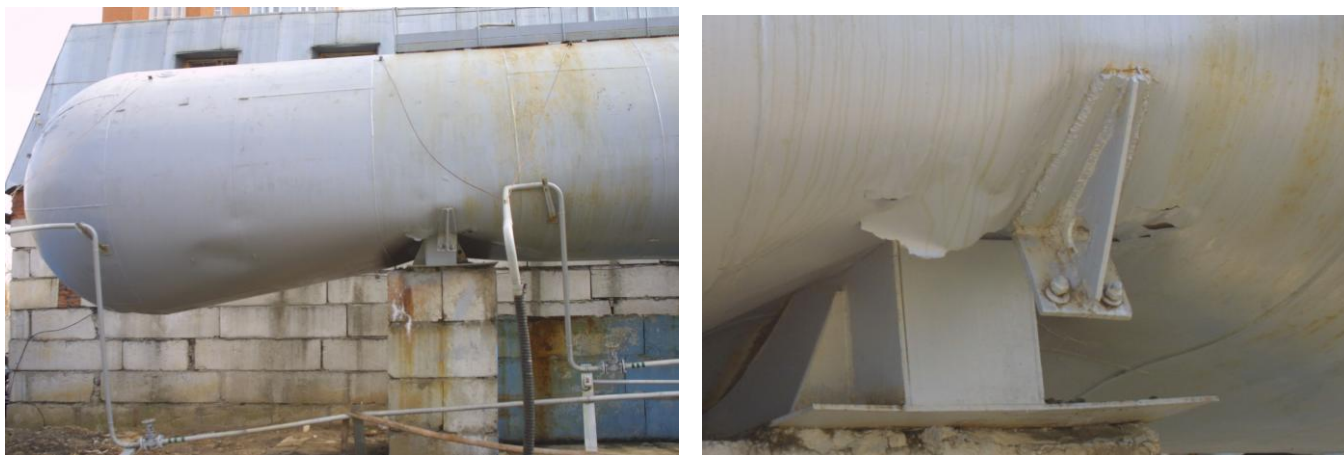
Фото 1. Деформация корпуса газгольдера объемом 175\text{ м}^3 в зоне опоры (2006 г.)
