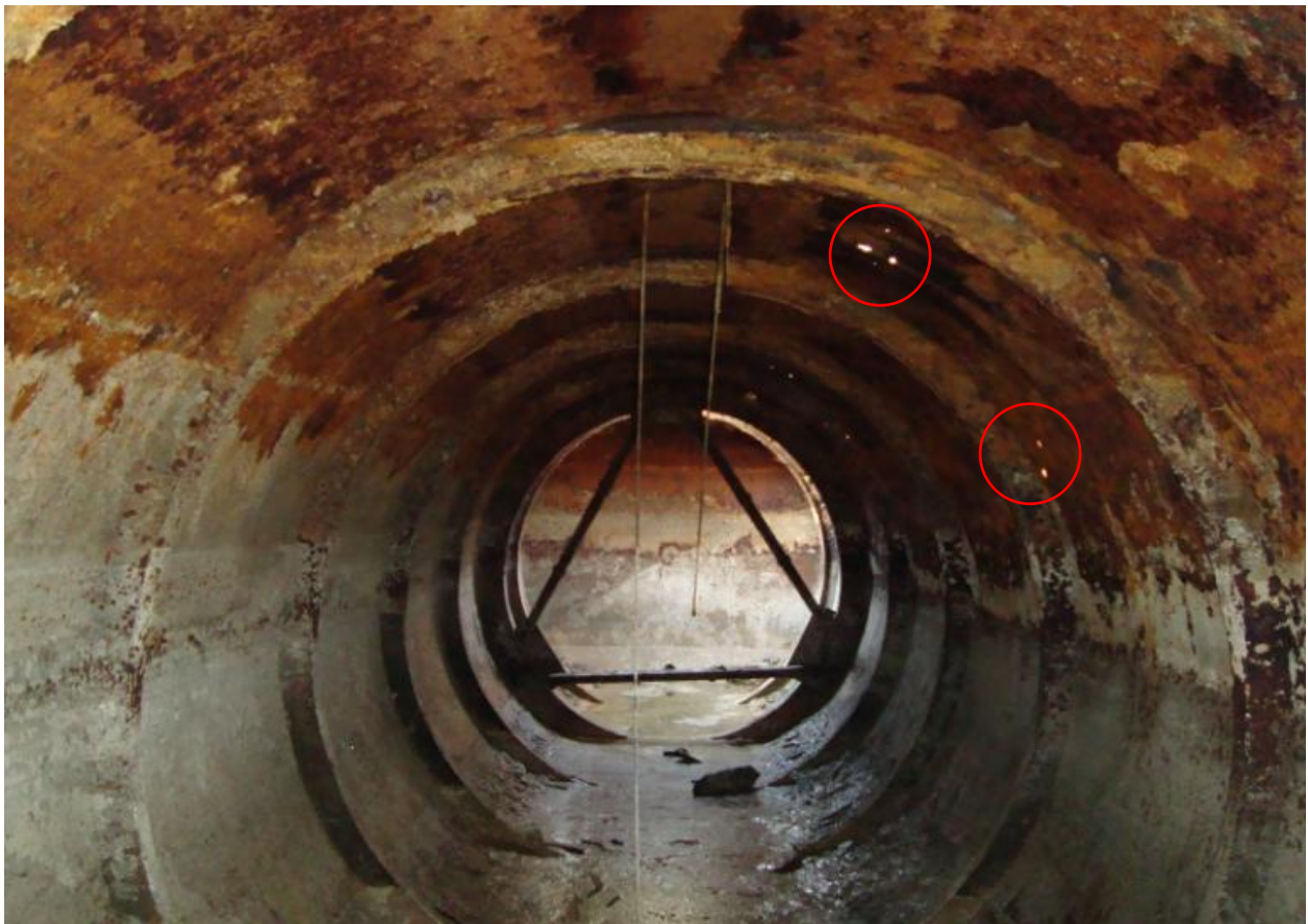
Фото 17 Внутренняя поверхность РГС 200 производства ОАО «Опытный завод Гидромонтаж» п. Селятино
