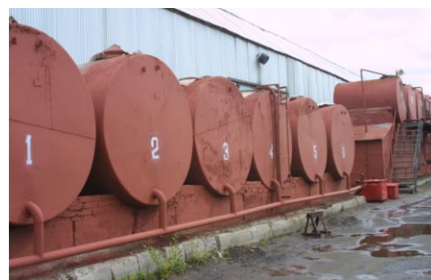
Фото 7. Резервуары объемом 10 м 3
