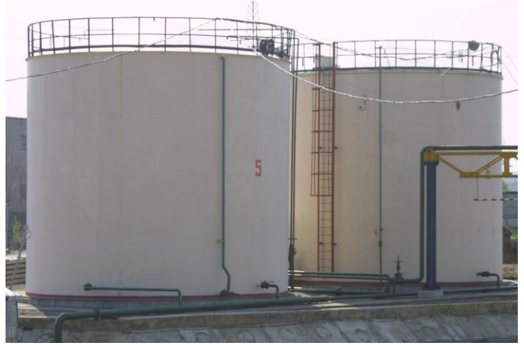
Фото 11. Резервуары объемом 200 м 3
