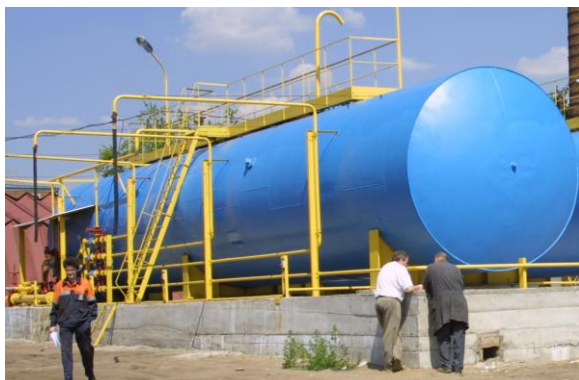
Фото 3. Резервуар объемом 200 м 3
