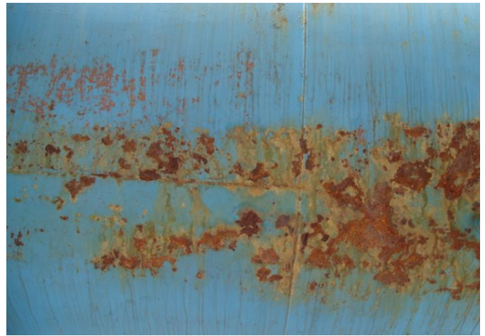
Фото 21. РГС-200 атмосферная коррозия
