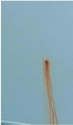
Фото 20. РВС-1000 сквозное повреждение стенки
